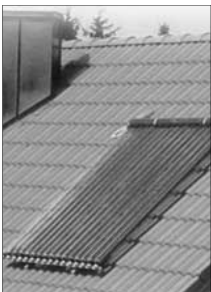
Un pannello solare installato sul tetto
